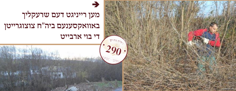
Edeleny, Hungary November 8, 2017 דער ביה"ח פולקאם גערייניגט מען רייניגט דעם שרעקליך באוואקסענעם ביה"ח צוצוגרייטן די בוי ארבייט
